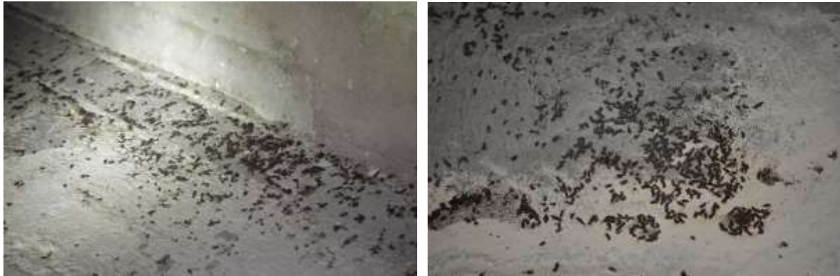
Abbildung 5 und 6: Kotstellen im Bauwerk
