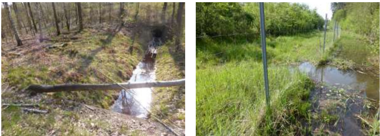
Abbildung 16 und 17: Verstopftes Rohr auf der Autobahnzwischenfläche (li) und genutzte Querung des bestehenden Wildschutzzauns durch den Biber (re)
